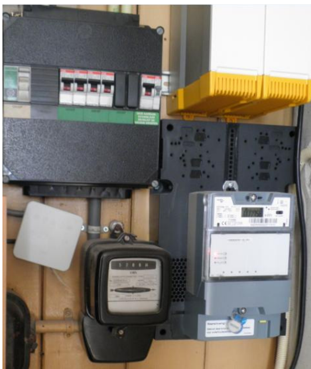
Meterkast met extra aardlekschakelaar voor de Steca netomvormers We zien hier links de groepen kast, daaronder de kWh draaischijfmeter van de netbeheerder en daarnaast de digitale teruglevermeter die het aantal kWh aan zonne-energie registreert. Boven deze meter zien we nog een stukje geel/wit van de netomvormers.
