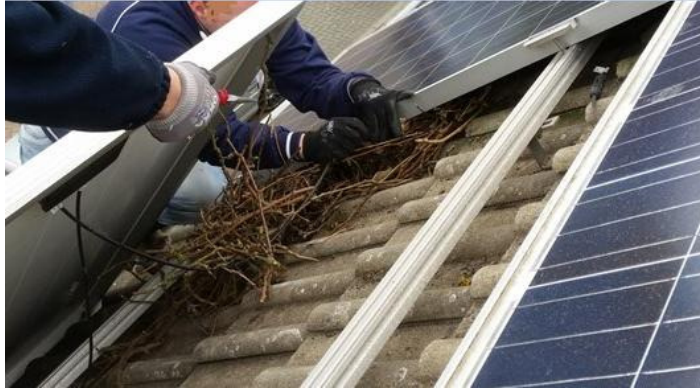
Een vogelnest van takken onder de zonnepanelen Bron: energieambassadeurs.nl
