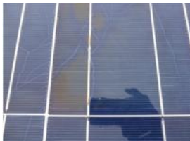
Zonnepaneel met celbreuken, slakkesporen en oververhitte delen
