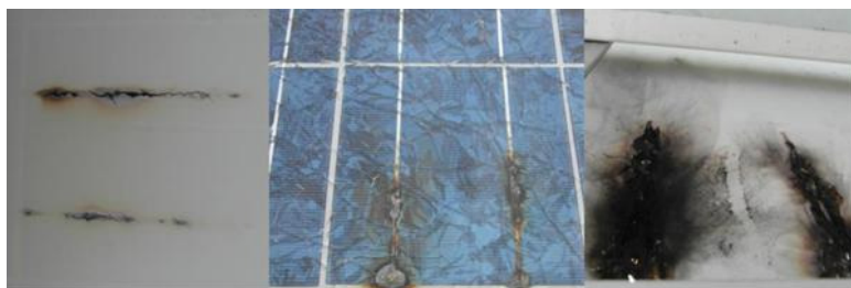
Schroeiende en brandende busbars bij slecht gesoldeerde zonnepanelen Bron: PV-magazine
