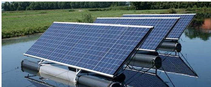
Drijvende dubbelzijdige zonnepanelen
